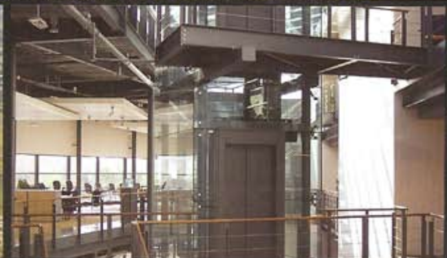
BRANDWEERLIFTEN EN BOUWBESLUIT
